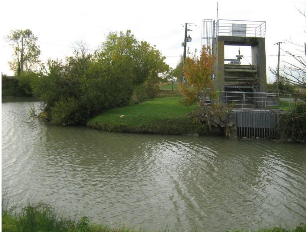
Station de pompage de la Bridoire permettant l'alimentation du canal Charente-Seudre
