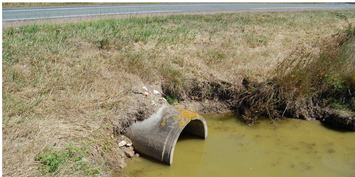
Busage ne permettant aucun passage sécurisé pour la faune (Marais de la Beaune, Rochefort).
